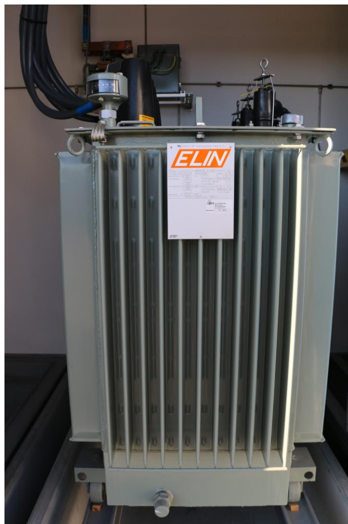
Transformator in der Transformatorenstation Neumatt
